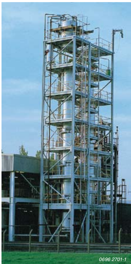
Блок полимеризации с оборудованием компании Зульцер Хемтех на установке производства полистирола
